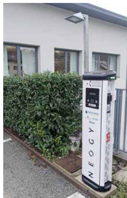
Colonnina ricarica elettrica presso la filiale di San Donà
